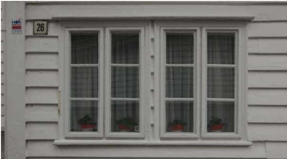
Figur 43. Skudeneshavn. Søragedå 26. Torams sidehengslete empirevinduer med originale beslag og gerikter. Som på mange andre hus i Skudeneshavn, er det montert utvendige dobbelt/vare/isolasjonsvinduer på originalvinduene. Dette innebærer at det ikke var mulig å utføre undersøkelsene ved å lage stratigrafiske fargelagsavdekkinger. Undersøkelsene av vinduene er utført ved hjelp av feltmikroskop. Foto: J. Brønne. September 2016.
