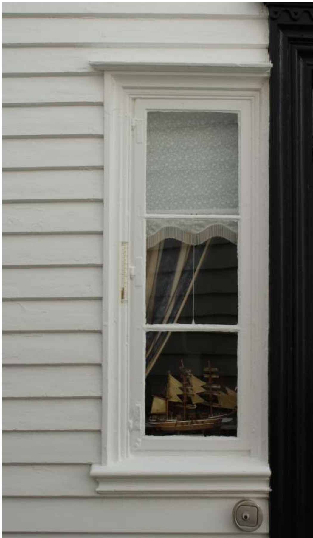
Figur 14. Skudeneshavn. Søragedå 18, sett fra nordvest. Vinduet på nordsiden av døra. Panel, vinduer og gerikter er opprinnelige. Foto: J. Brønne. September 2016.
