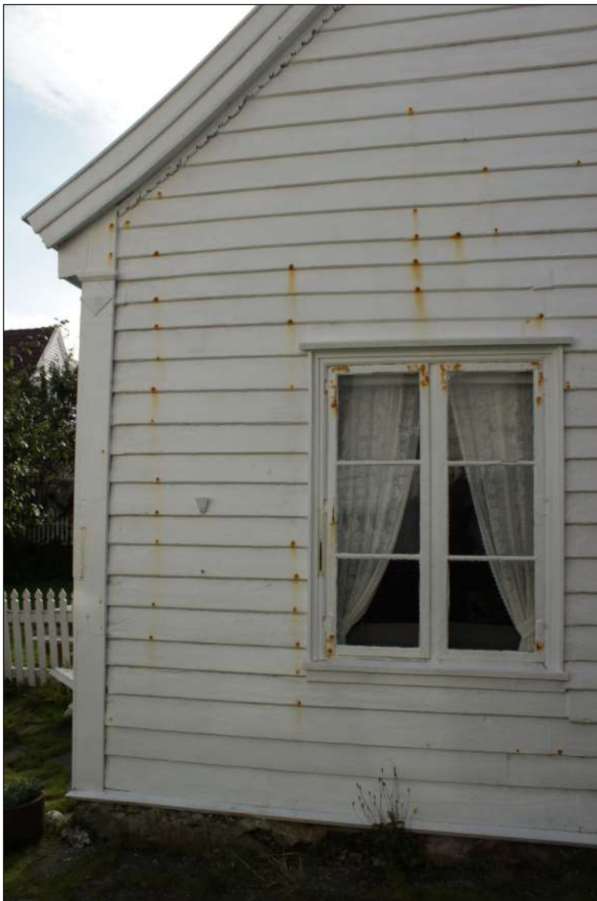
Figur 24. Skudeneshavn. Søragedå 19. Nordøsthjørnet med rustskader etter smidd spiker i panelet og jernbeslagene på vinduene. Legg merke til den fine prydfasetten øverst på laftekassa. Fargene på denne følger fargene på laftekassa. Foto: J. Brønne. September 2016.
