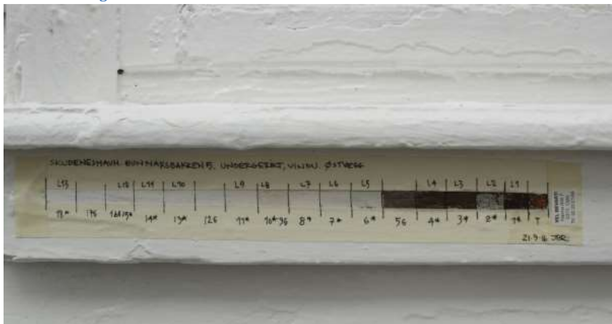
Figur 107. Skudeneshavn. Gunnarsbakken 5. Fargelagsavdekking av malinglagene på vindu. Foto: J. Brønne. September 2016.
