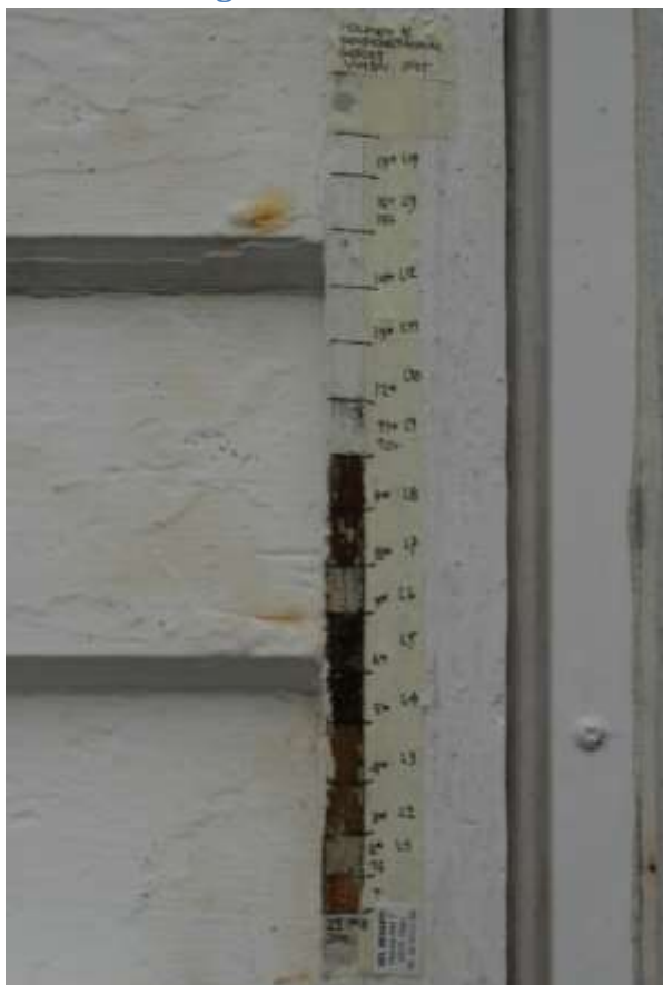
Figur 75. Holmen 5. Fargelagsavdekking på vindusgerikter. Foto: J. Brønne. September 2016.
