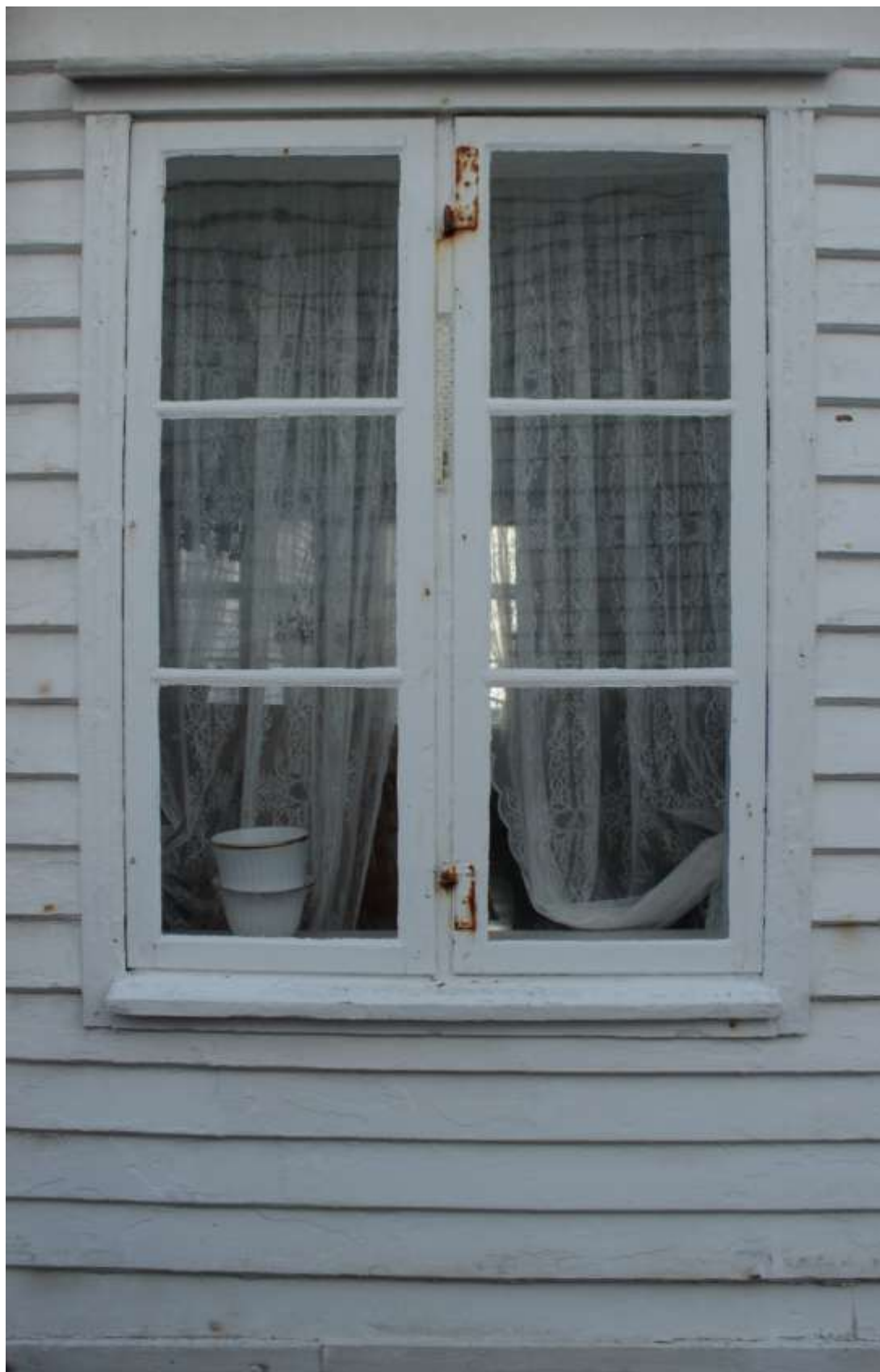
Figur 92. Skudeneshavn. Holmen 16. Torams empirevindu, med en fastramme og en hengslet på midtposten. Tre glass i tilnærmet kvadratisk format i hver ramme. Opprinnelige beslag. Side- og toppgeriktene har doble konkave kannelinger. Foto: J. Brønne. September 2016.
