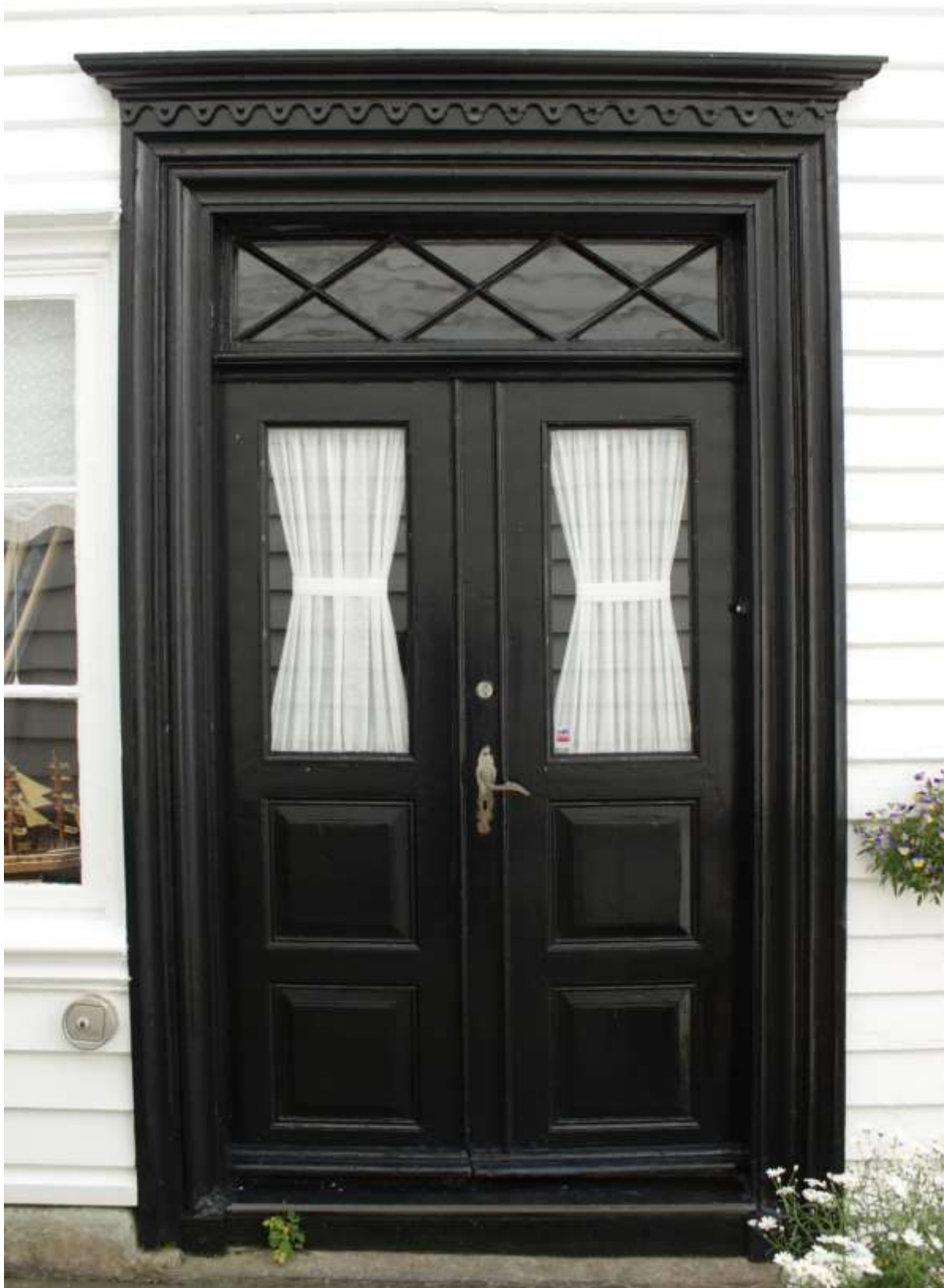
Figur 15. Skudeneshavn. Søragedå 18. Hoveddøra mot nordvest. To fløyet innadslående senempiredør. To kvadratiske fyllinger i basen på hver dør. De øverste fyllingene er erstattet med store glass i stående format. Dette er trolig original utførelse. Dørgeriktene som er en type som finnes i overgangen mellom senempiren og sveitserstilen har uvanlig, rik profilering. Selv om døra har glass, har døra også tradisjonelt overlysvindu. Vinduet har senempirens diagonalstilte sprosser. Bekroningen har bølget senempireutsveifing med dreide knotter. Foto: J. Brønne. September 2016.
