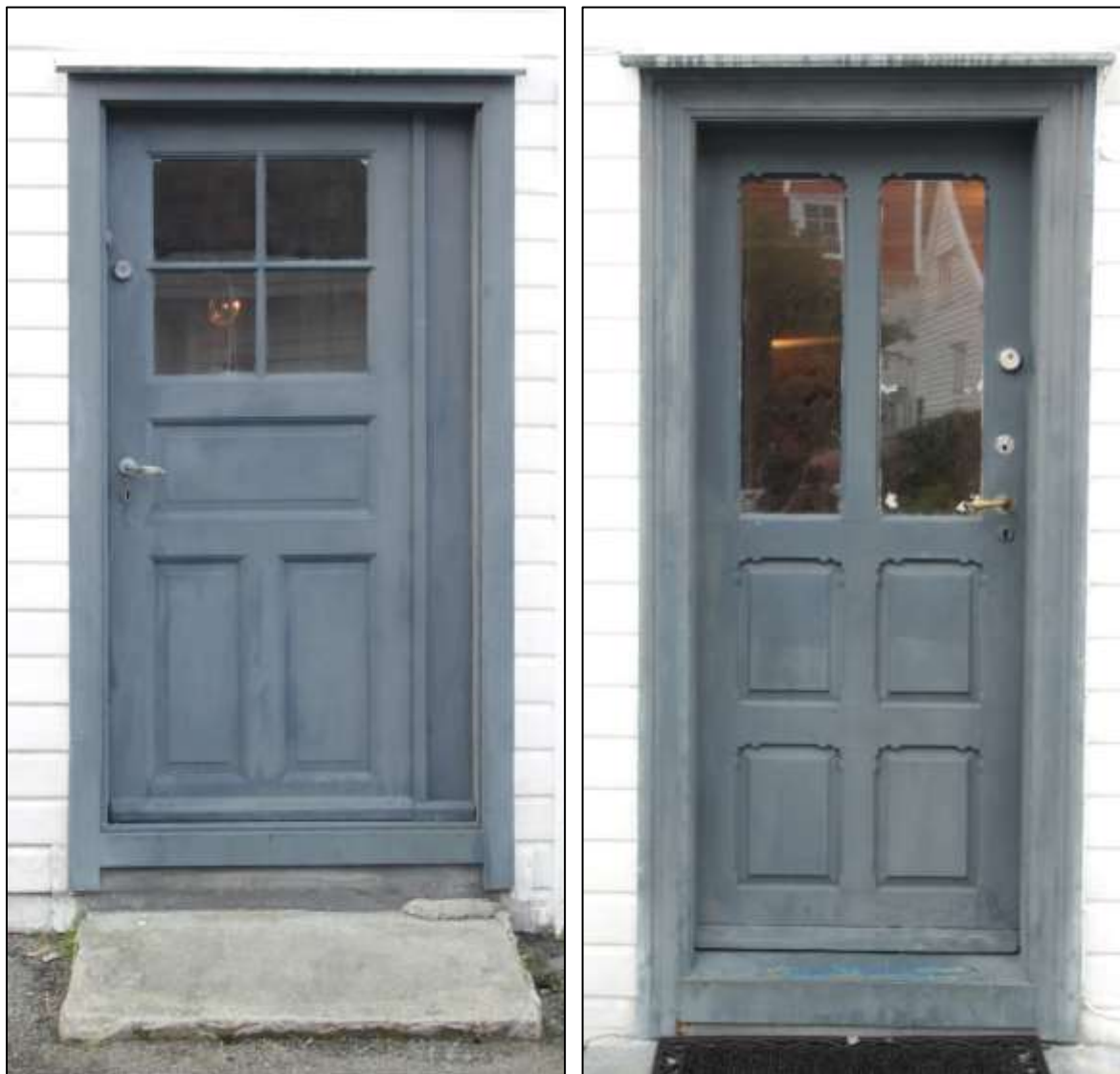
Figur 89. Skudeneshavn. Holmen 16. Til venstre, Dør C, den vestligste døra i østfasaden på tilbygget. Firefyllings, innadslående sveisertsdør, med fire glass i øvre fylling. Døra er trolig fra 1920-åra. Enkle sekundære, glattkants gerikter. Til høyre, Dør A, seksfyllings, innadslående sveitserdør. De nedre fire fyllingene har stående format. Alle ramtrærne har avfasinger og utsveifinger inn mot fyllingene. I de to øverste fyllingene er det satt inn store glass i stående format. Døra er trolig fra ombyggingene i 1890-åra. Profilerte sveitserstilsgerikter. Foto: J. Brønne. September 2016.
